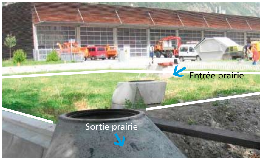
Prairie filtrante de Brigue (A9, Valais)
