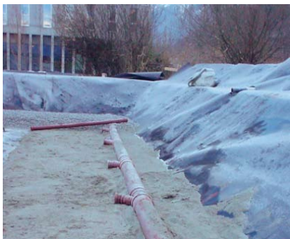
Bassin de Brigue (système de drainage et confinement)
